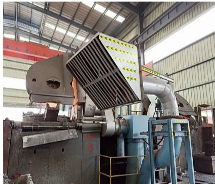
电炉环保除尘系统
